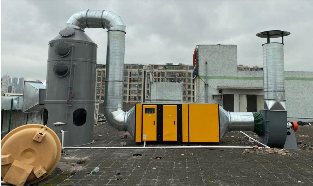
图 4-1 已建废气收集设施
